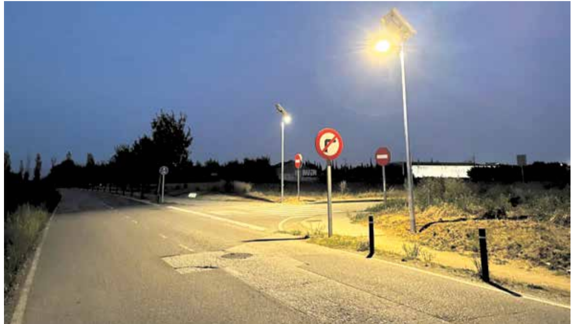
MILLORA DE LA SEGURETAT. Els dos fanals amb lluminàries led, que s'alimenten d'energia solar
