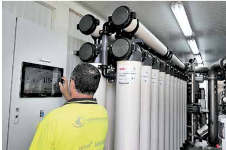
ULTRAFILTRATGE. Instal·lacions al parc del Trabuc de Castelló d'Empúries
