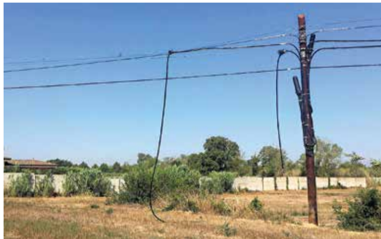
TALL AMB CISALLA. La zona on van fer malbé el cablejat
