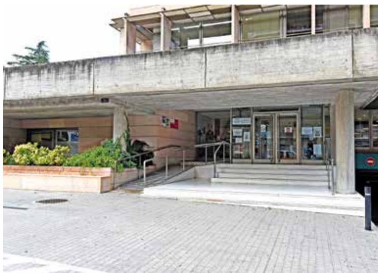
EDIFICI DE L'OMAC. A la planta baixa els treballs ja es van fer l'any 2018 ÀNGEL REYNAL
