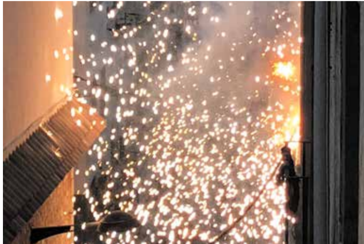
CENTRE DE TRANSFORMACIÓ. Va incendiar-se el passat 30 de juliol
