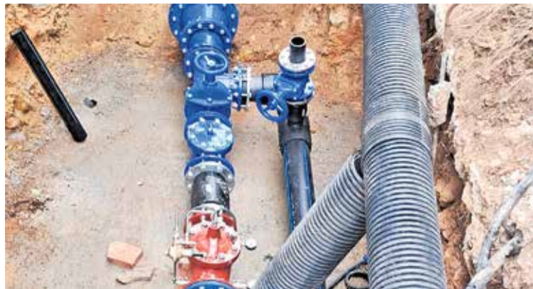
EQUIPS DE MONITORATGE. Connectats a un centre de control
