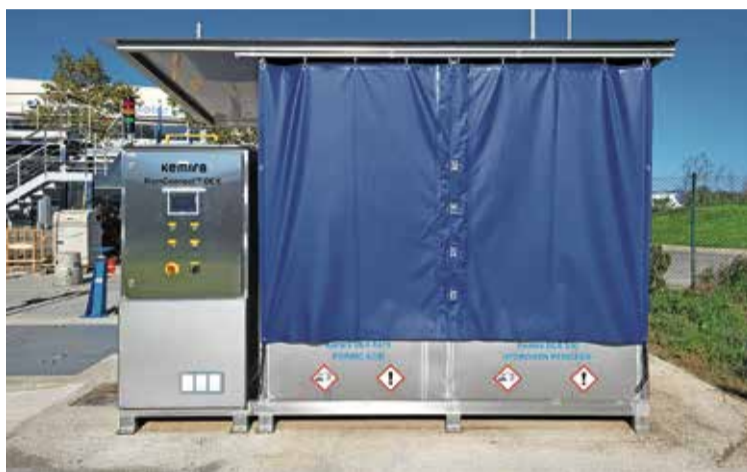
MÒDUL DE DESINFECCIÓ. S'ha instal·lat al costat d'on surt l'aigua ja tractada
