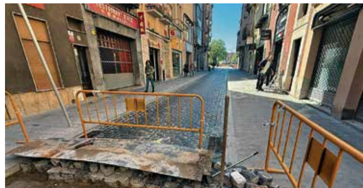
DURANT LES OBRES. Calia recol·locar llambordes en un tram ■ AJ. DE FIGUERES
