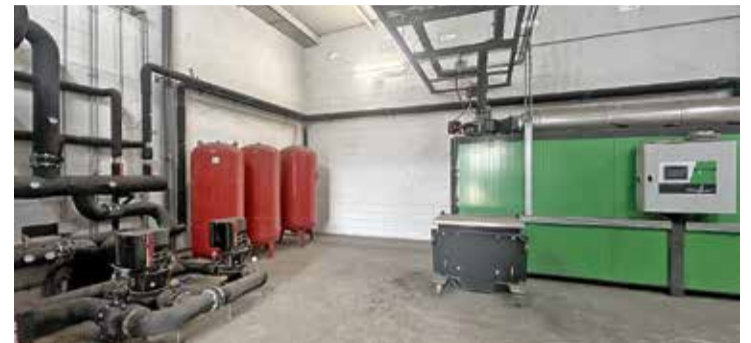
XARXA DE CALOR PER BIOMASSA. Ampliada per a nous equipaments HORA NOVA
