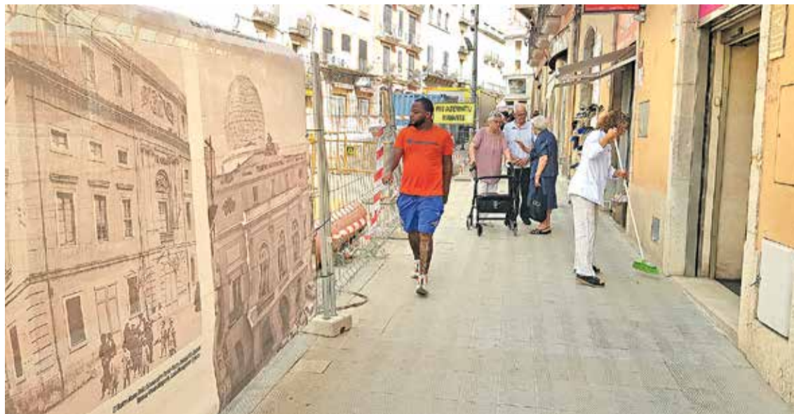
POSSIBLE ESCURÇAMENT DE TERMINIS. L'última data fixada per al final de les obres és el gener del 2026
