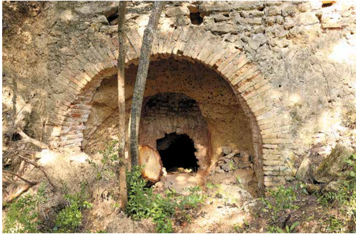
EL FORN. La construcció de rajols ha quedat al descobert després d'uns treballs forestals
