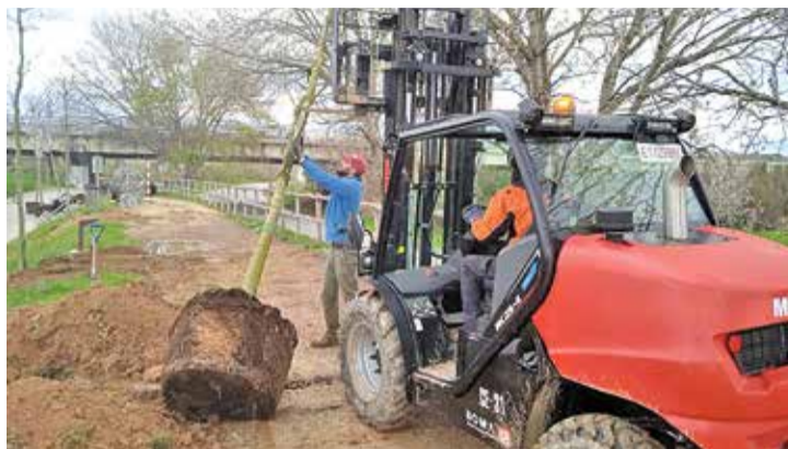
UN TRAM DE 4,7 KM. Entre el pont de Sant Pere i la gola de la Muga
