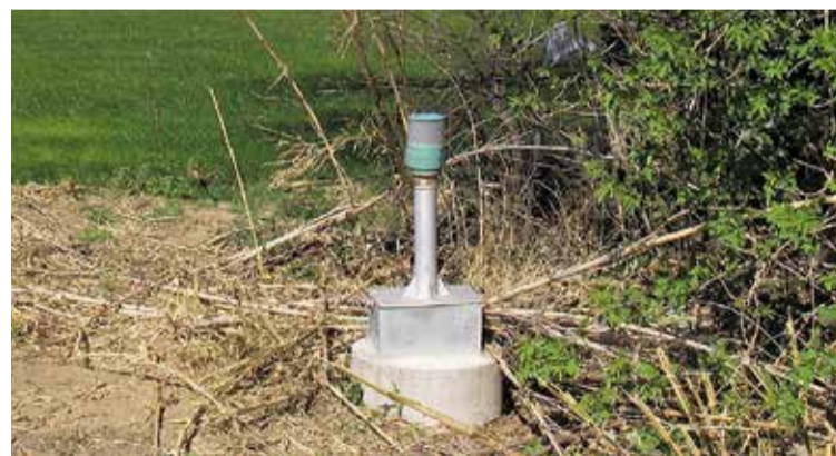
PIEZÒMETRE. Permeten mesurar el nivell i les característiques de l'aigua ACA
