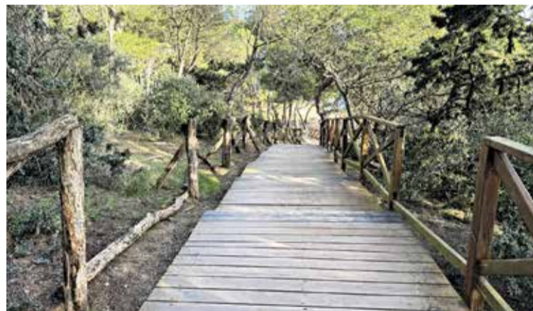
FUSTES MALMESES. S'han deteriorat pel pas del temps o per vandalisme
