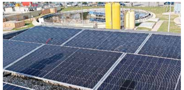
A L'ESTACIÓ DEPURADORA. S'hi han instal·lat 146 panells de 480 Wc AJ. FIGUERES
