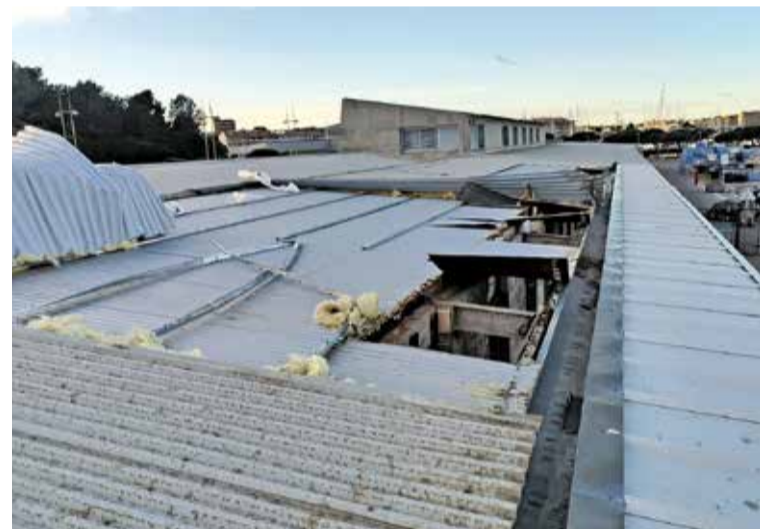
DÀRSENA PESQUERA DEL PORT. La coberta malmesa per la tramuntanada
