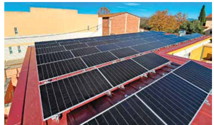
BAR DE LA PISCINA. És on s'han instal·lat 57 plaques fotovoltaïques
