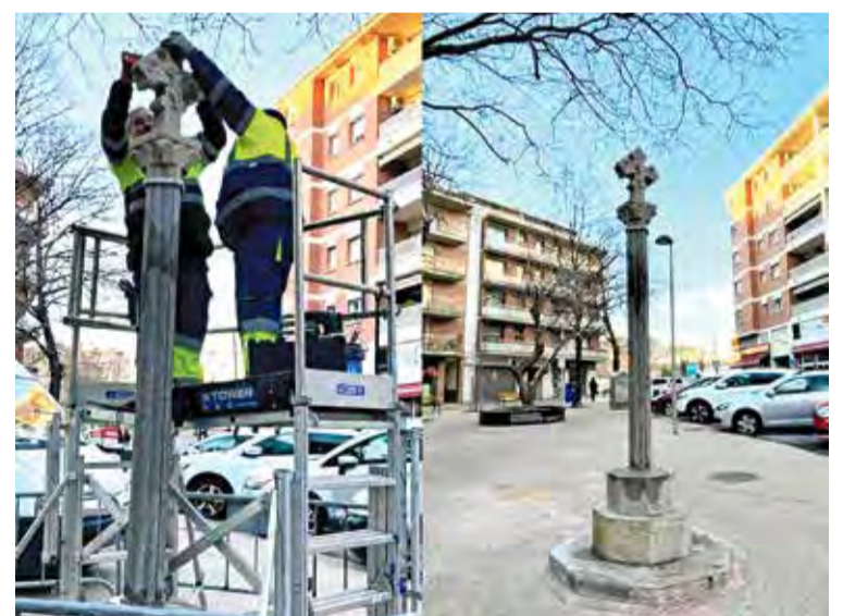
LA INSTAL·LACIÓ. La creu es va trencar el passat mes de setembre
