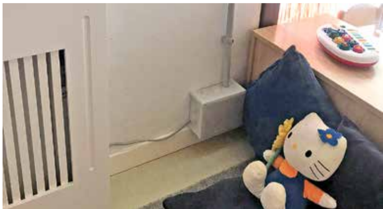
BALLMANETES. De moment s'han instal·lat radiadors a les aules Alternativa per l'Escala
