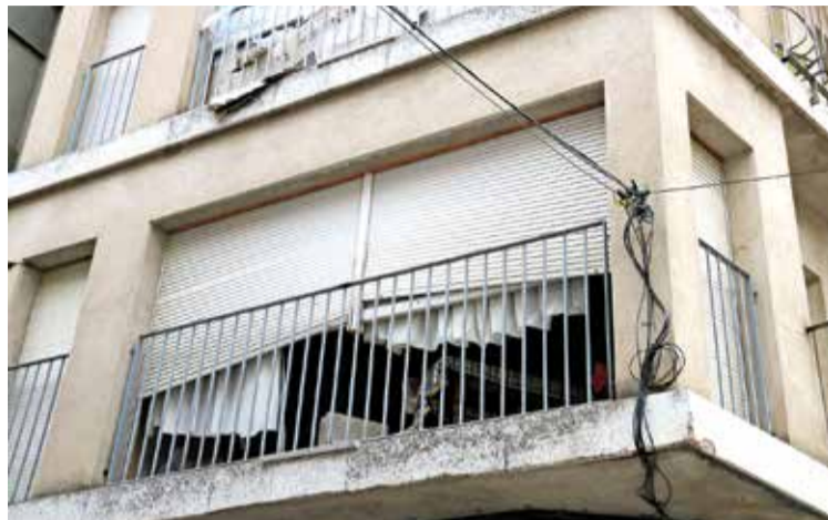
DOS PISOS ENCARA OCUPATS. Un al carrer Colomer i l'altre al carrer Núria G. TUBERT
