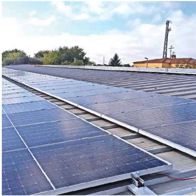
A LES MÈLIES. Les plaques instal·lades a l'edifici del centre educatiu
