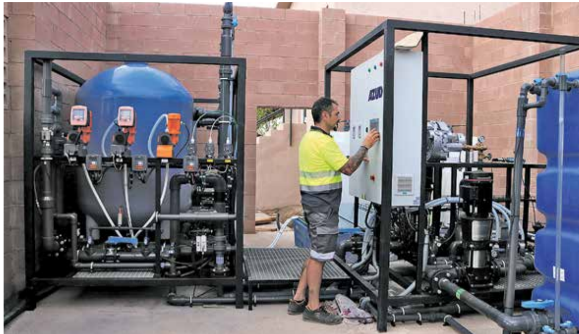
ESTACIÓ DE TRACTAMENT D'AIGUA POTABLE. Es posarà en marxa quan rebí l'aval de la Generalitat, previsiblement a l'octubre ACN
